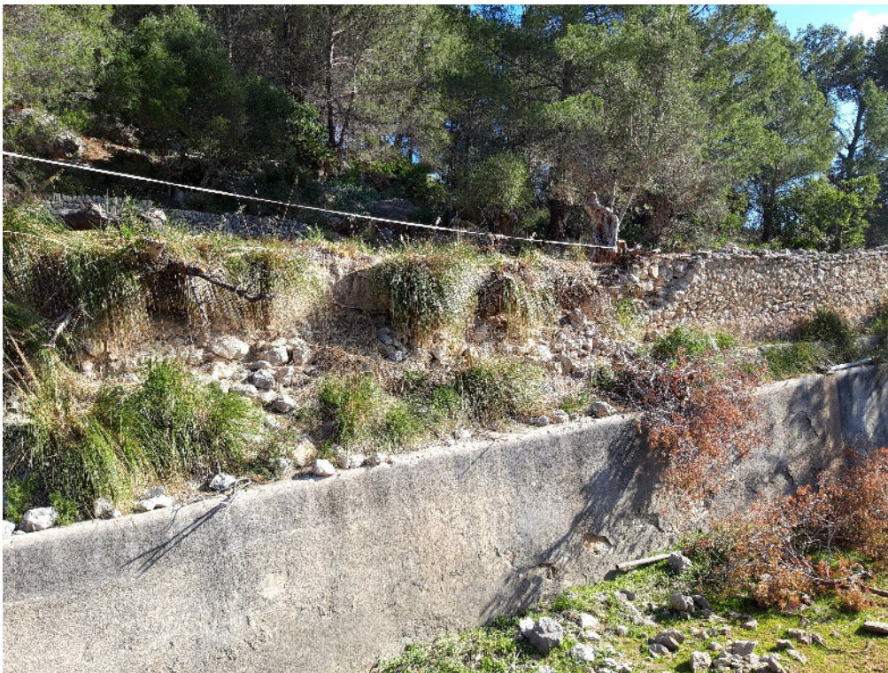
Vista de l'estat actual de la paret del safareig
