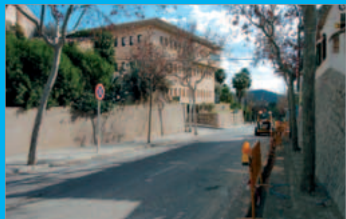
La entrada de Calvià Vila tendrá nueva iluminación.
