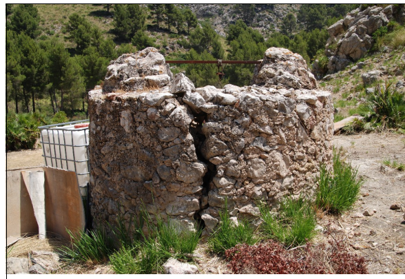
304-1: Grieta del coll.
