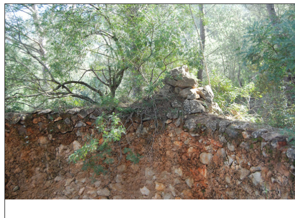
Descripción: Restos del muro de sustento de la viga.
