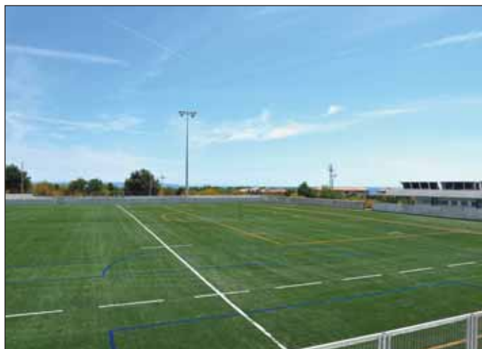
Imagen de la nueva instalación, en la recta final de las obras.
